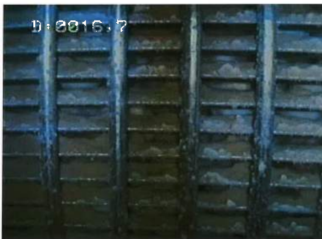
20- Tubage inox crépiné – fentes partiellement colmatées de fines
