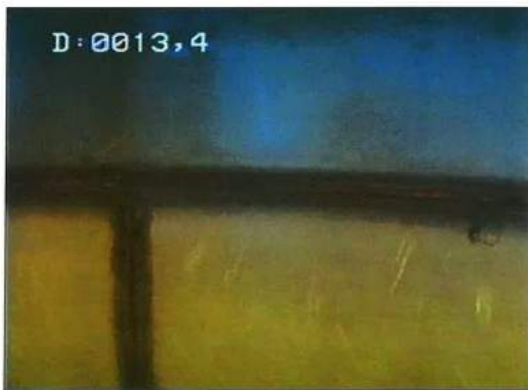
14- Tubage inox plein – soudure inter-tubes usinée propre
