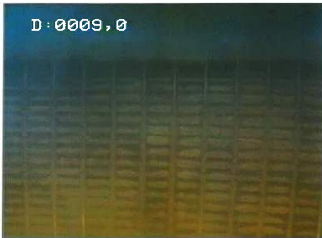
7- Tubage inox crépiné - fentes partiellement colmatées par des fines
