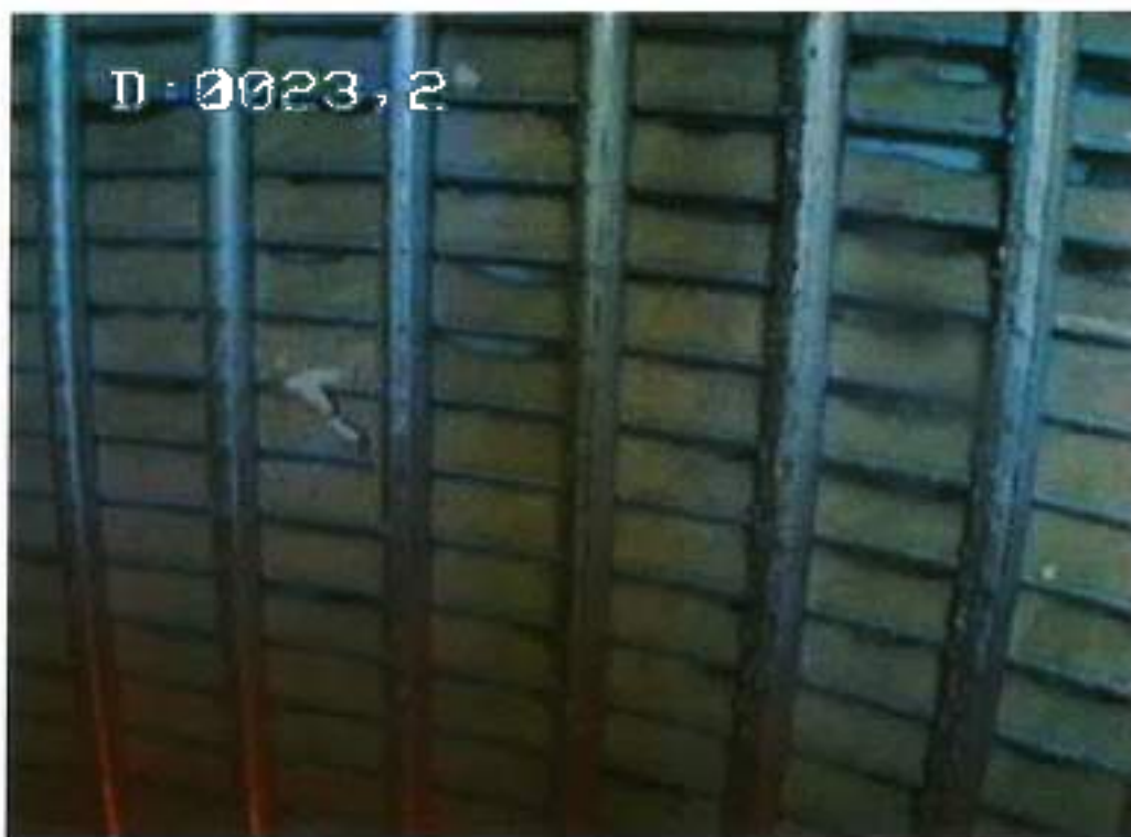
26- Tubage inox créplé – fentes partiellement colmatées par dépôts de fines
