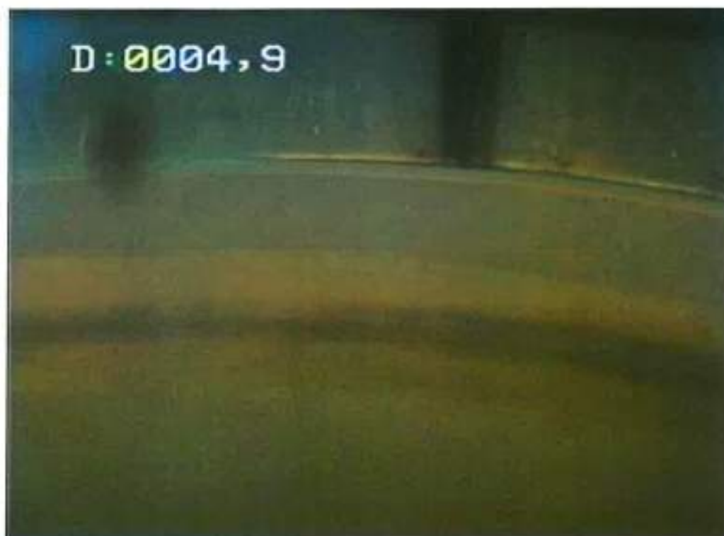
5- Tubage inox plein - soudure manchonnée, eau légèrement chargée en MES
