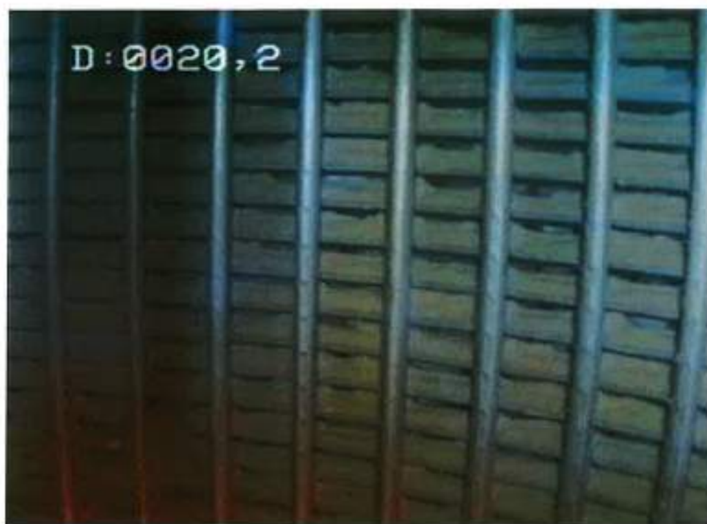
23- Tubage inox crépiné – fentes partiellement colmatées de fines
