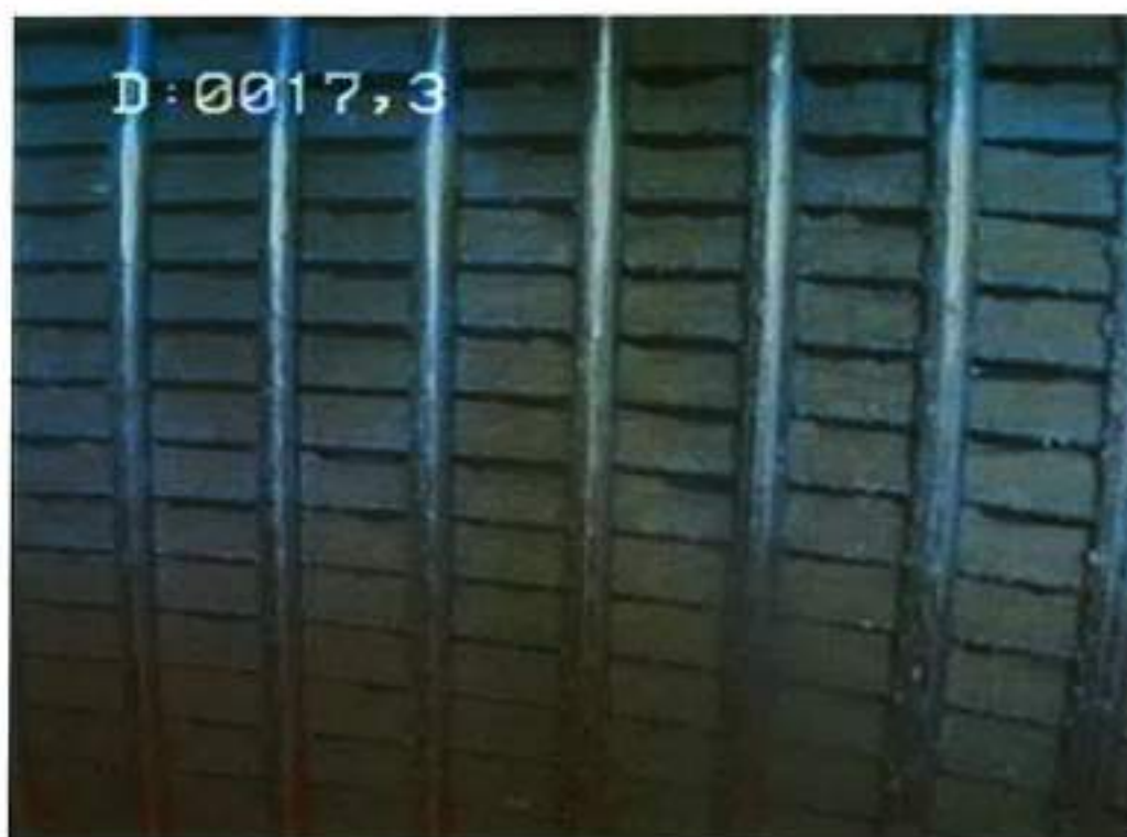
21- Tubage inox crépiné – fentes partiellement colmatées de fines
