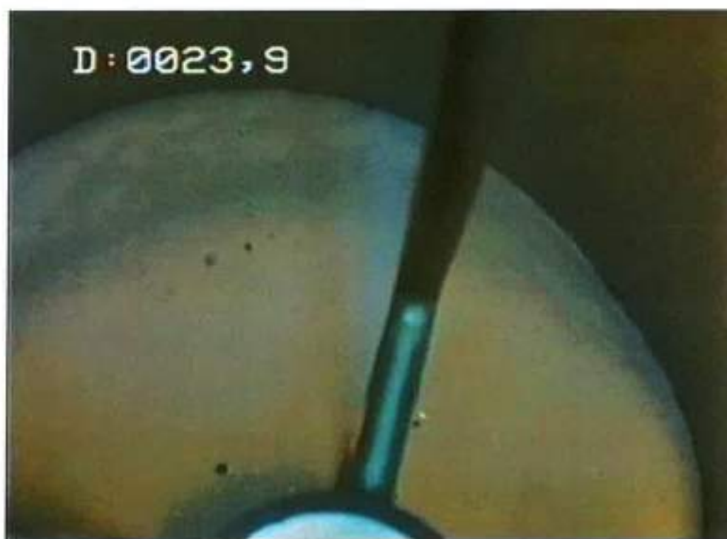
28- Fin de l'inspection télévisée – accumulation de fines particules crayeuses
